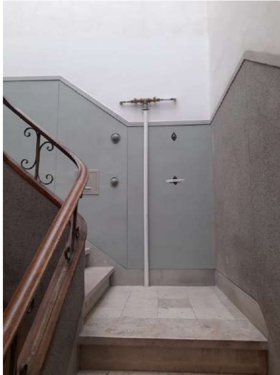
Coluna montante de água, R. Cor. Marques Leitão, 1
