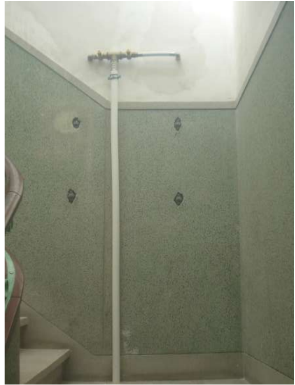
Coluna montante de água, R. Cor. Marques Leitão, 7
